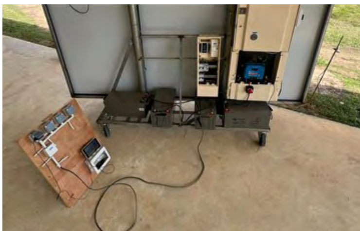
Figure 2 : Structure repliée et son installation électrique
